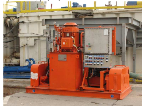
system oczyszczania płuczki - wirówka
