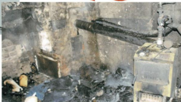
Kotłownia spalona przy okazji pożaru sadzy, fot. miastokolobrzeg.pl
